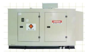
非常用電源設備
